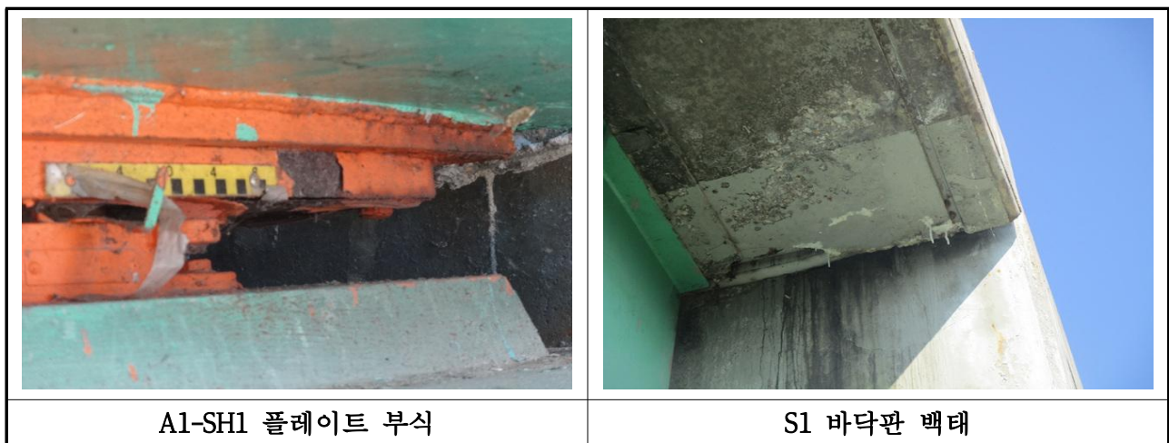
【사진 7.1】 신축이음 누수에 따른 손상 발생 현황
